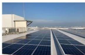
太陽光発電設備（PV：Photovoltaic Power Generation）
